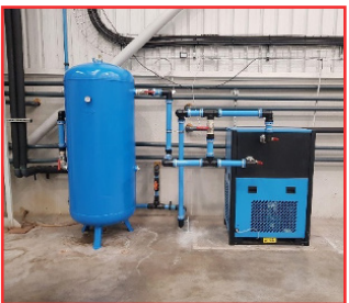
Installation et traitement air comprimé
