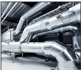
Aéraulique pour ventilation
