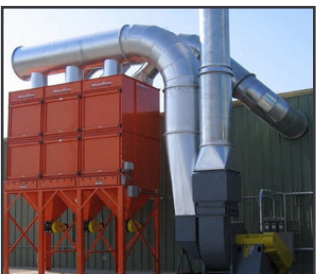
Aéraulique pour extraction centralisée
